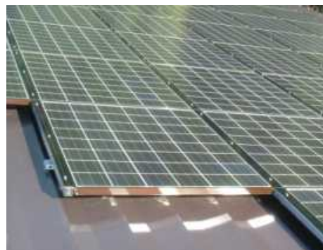
人丸水源地 ソーラー設備
