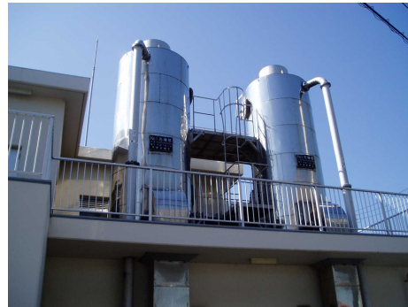
寿第2水源地 エアレーション装置
