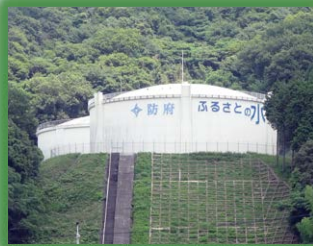
②人丸配水池
