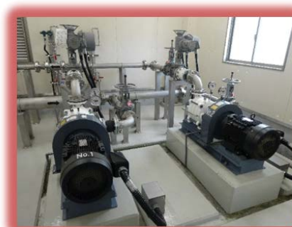
【ポンプ所設備】
