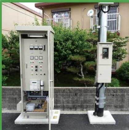
【マンホールポンプ制御盤】
