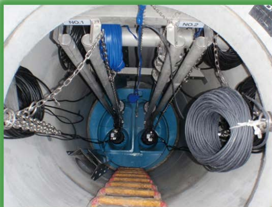
【マンホールポンプ内部】
