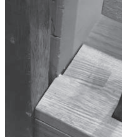
ひび割れた壁 階段と壁に隙間
