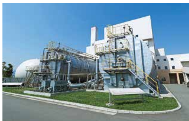
廃棄物発電施設
