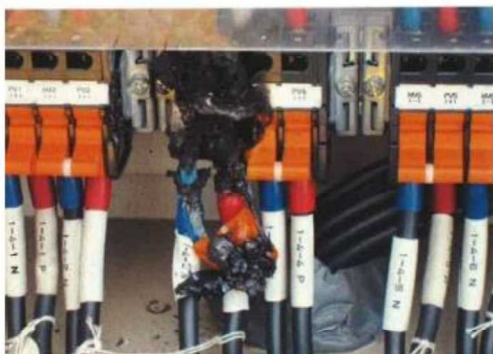
端子台の焼損
