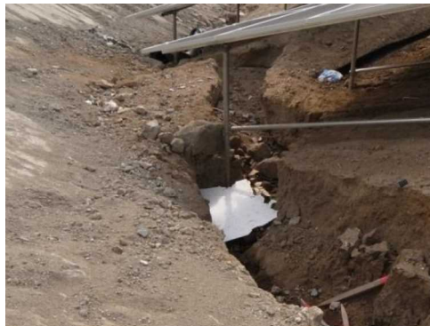
地割れの事例
