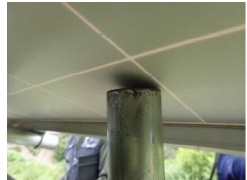
架台とモジュールの接近しすぎ
