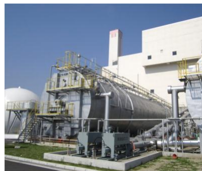
クリーンセンター内にある 廃棄物発電施設
