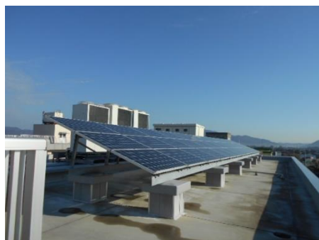
市内小学校に設置された太陽光発電システム
