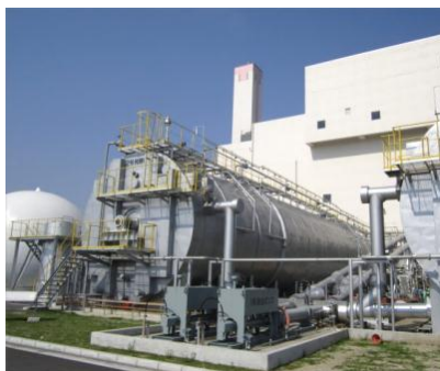
廃棄物発電施設
