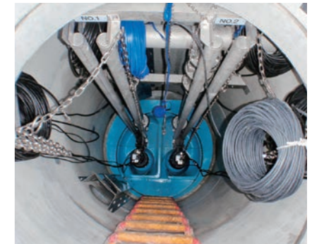
マンホールポンプ内部
