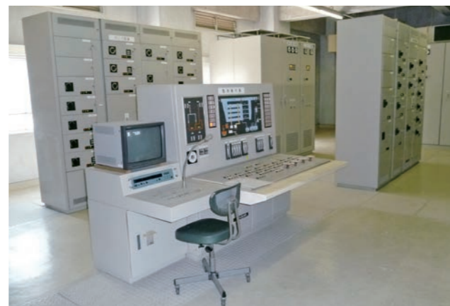
⑨古祖原ポンプ場
