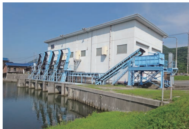
⑥新田ポンプ場
