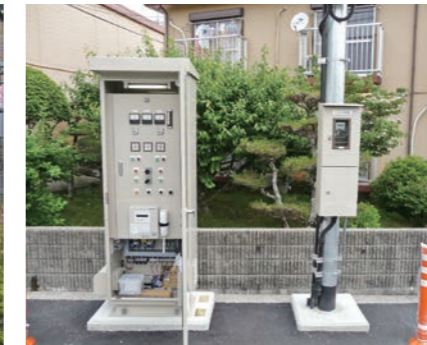
南山手マンホールポンプ
