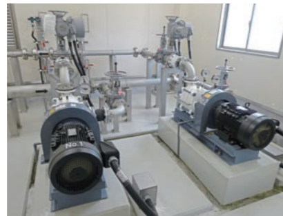
② 富海増圧ポンプ所
