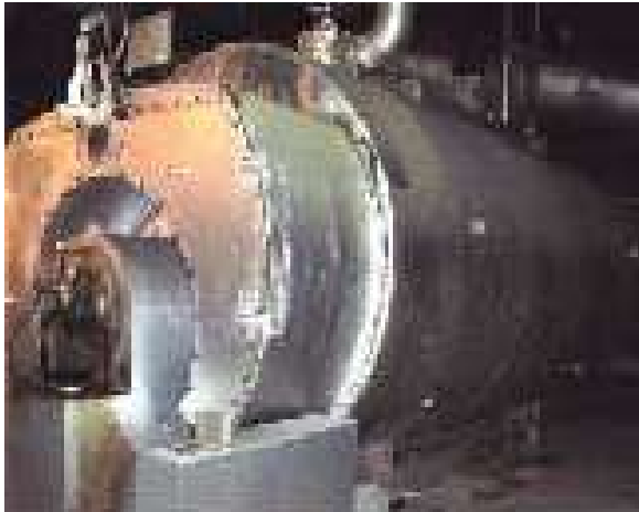
ボイラー の保温材
