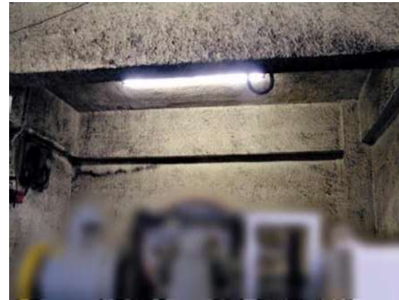
機械室吸音材
