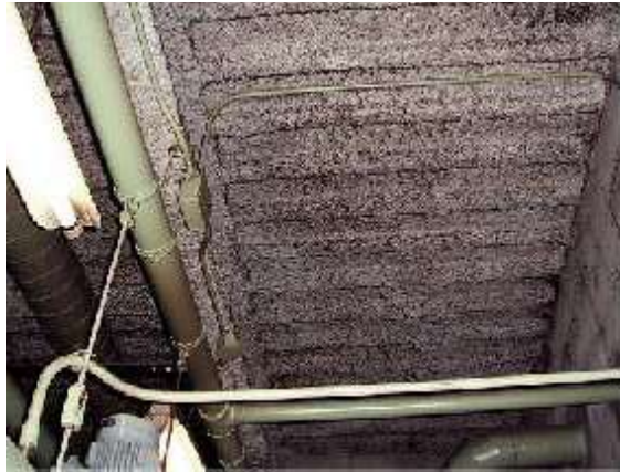
天井断熱材 天井、壁吸音材
