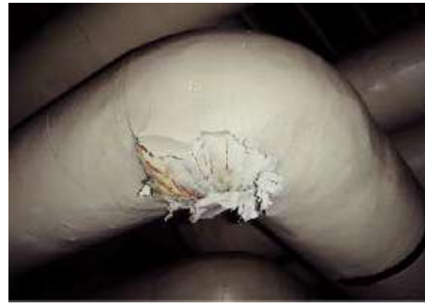
配管エルボの保温材①
