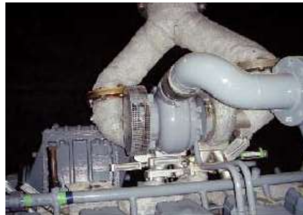
配管エルボの保温材②
