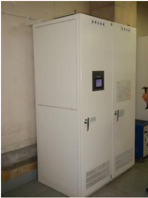
直流電源装置(外観)
