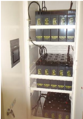
直流電源装置(内部)
