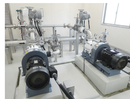
②富海増圧ポンプ所
