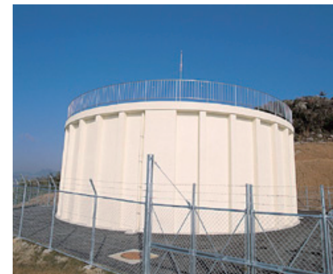
⑤大内配水池
