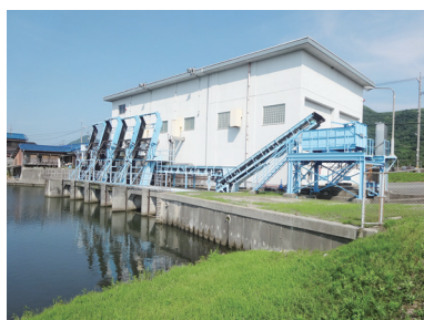
⑥ 新田ポンプ場
