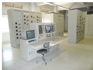
⑨ 古祖原ポンプ場
