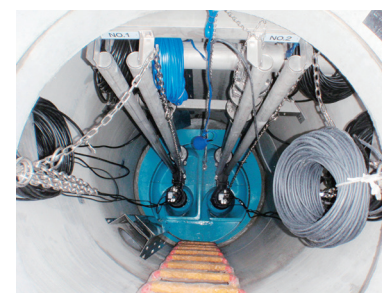
マンホールポンプ内部
