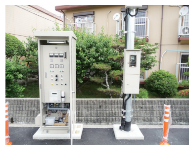
南山手マンホールポンプ
