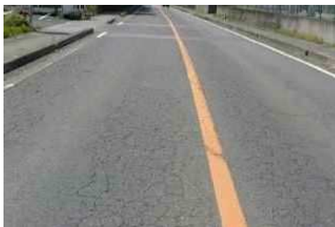
ひび割れ 45%程度の例
