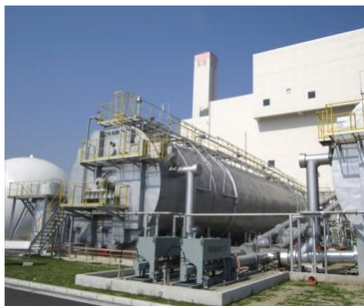
廃棄物発電施設
