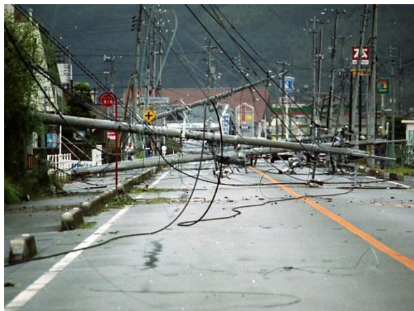
平成3年台風第19号による暴風被害（電柱の倒壊）
