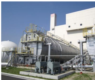
廃棄物発電施設
