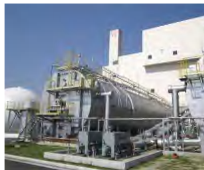
クリーンセンター内にある 廃棄物発電施設
