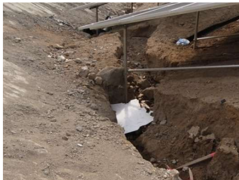
地割れの事例
