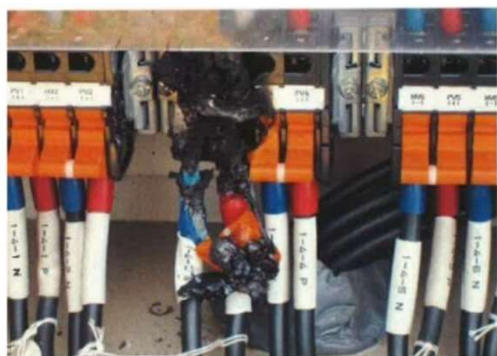
端子台の焼損
