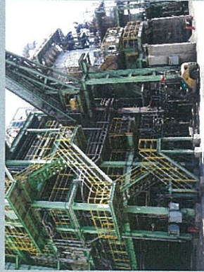
ガス化溶融炉
