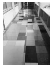
つぎはぎで補修された華城小学校の廊下
