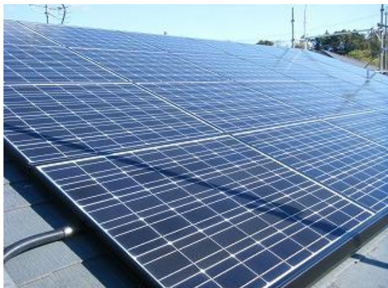
太陽光発電設備
