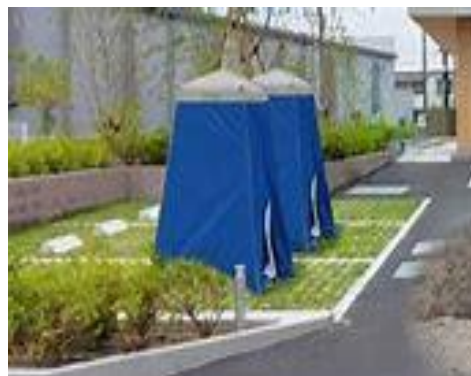
マンホールトイレの設置例
