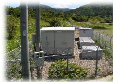
⑥北右田水源地 (H21.3 建設)
