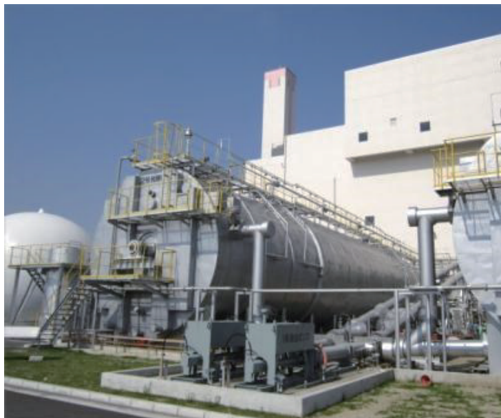
防府市クリーンセンター内にあるバイオガス化施設
